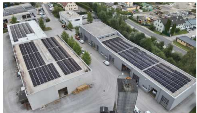
Ein Blick auf die beeindruckende Photovoltaik-Anlage auf den Dächern des Bauhofes
