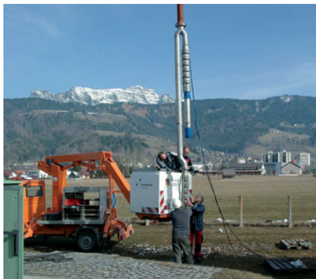
Der komplizierte Austausch der defekten Pumpen erfolgte durch die Mitarbeiter des Städtischen Bauhofes.
